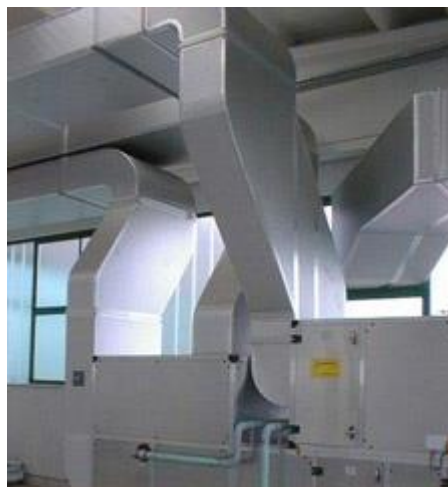
شکل ۱: یک سیستم کانال کشی نزدیک هواساز
