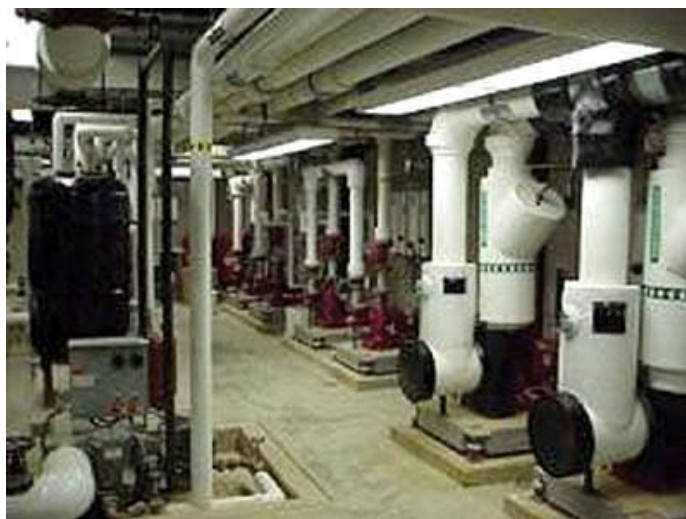
شکل ۲-۱۰: تصویری از یک موتورخانه گرمایش که با استفاده از عایقکاری مناسب مصرف انرژی را کاهش داده است
